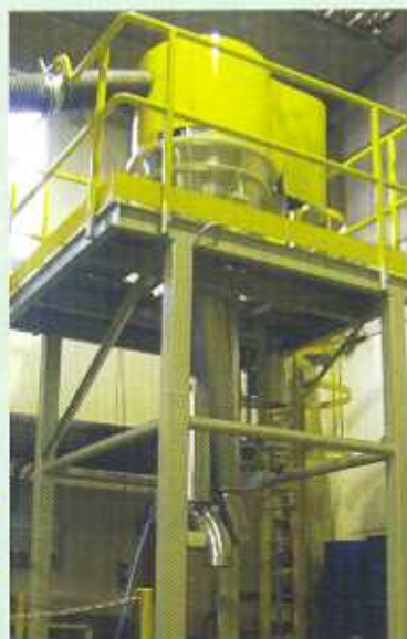
SEV-DS-80-3HS40 installato nel tecnologico di Locate Triulzi (MI) SEV-DS-80-3HS40 installed in the technology station in Locate Triulzi (MI)
